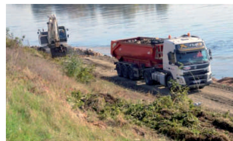
Travaux de renforcement de la levée du Val d'Authion à la Chapelle-sur-Loire (2017) Source : La Nouvelle République du Centre-Ouest
